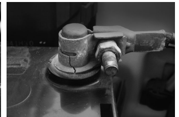
亀裂が入ったターミナル
