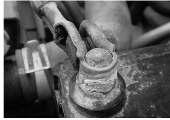
腐食したターミナル
