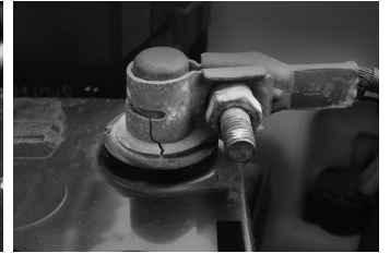
亀裂が入ったターミナル
