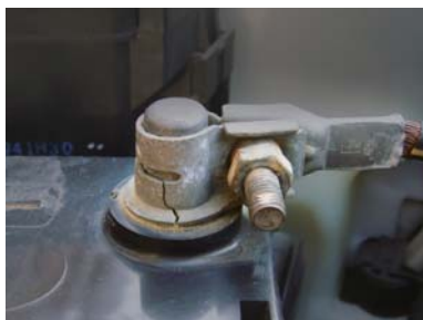
亀裂が入ったターミナル
